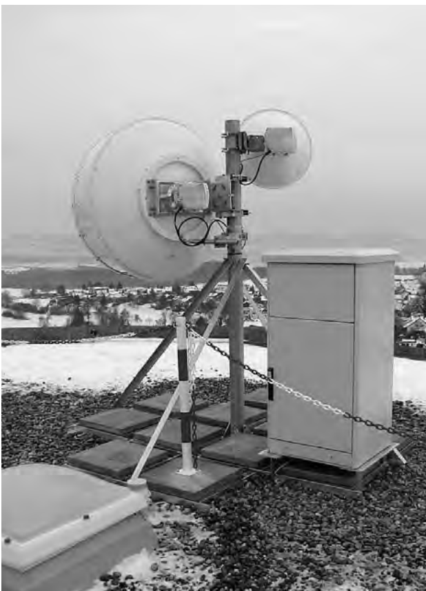
Antenne Wasserturm Börtlingen
